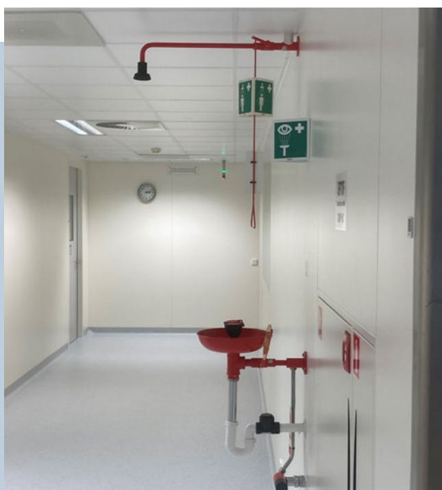
Figura 13-4: Una doccia e un lavaocchi in una farmacia di un ospedale (per scopi di emergenza in caso di incidente) presso il Meander Medical Centre, Paesi Bassi
